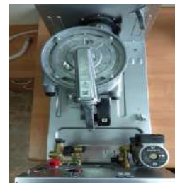
Насос GRUNDFOSS (Дания)
